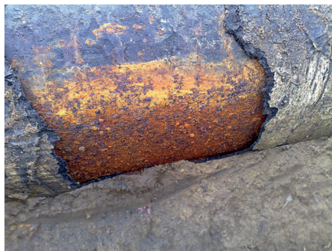
Plošná koroze v místech kde se pod tovární izolaci dostane voda
