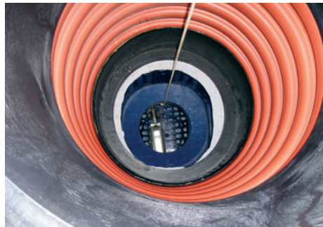
Pohled do šachtové roury TEGRA 600 s šachtovým adaptérem na boku Q-Bic
