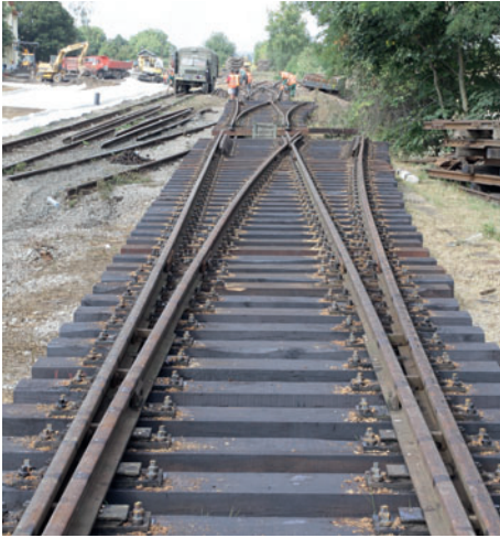
Regenerovaná výhybka. Při regeneraci byly vyměněny pražce, upevňovací a opraveny další části výhybky tak, aby mohla být konstrukce zabudována do kolejíště.
