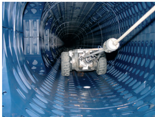
Revizní kanál Q-Bic pro inspekční kontrolu
