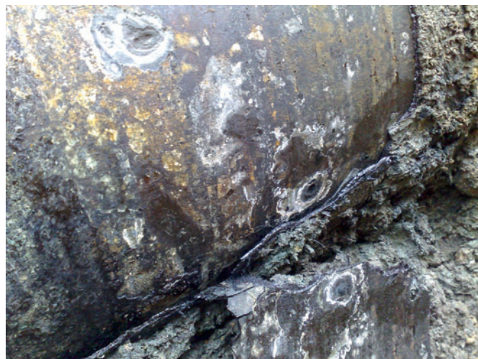
Důlková koroze v místech poškození izolace a výskytu bludných proudů
