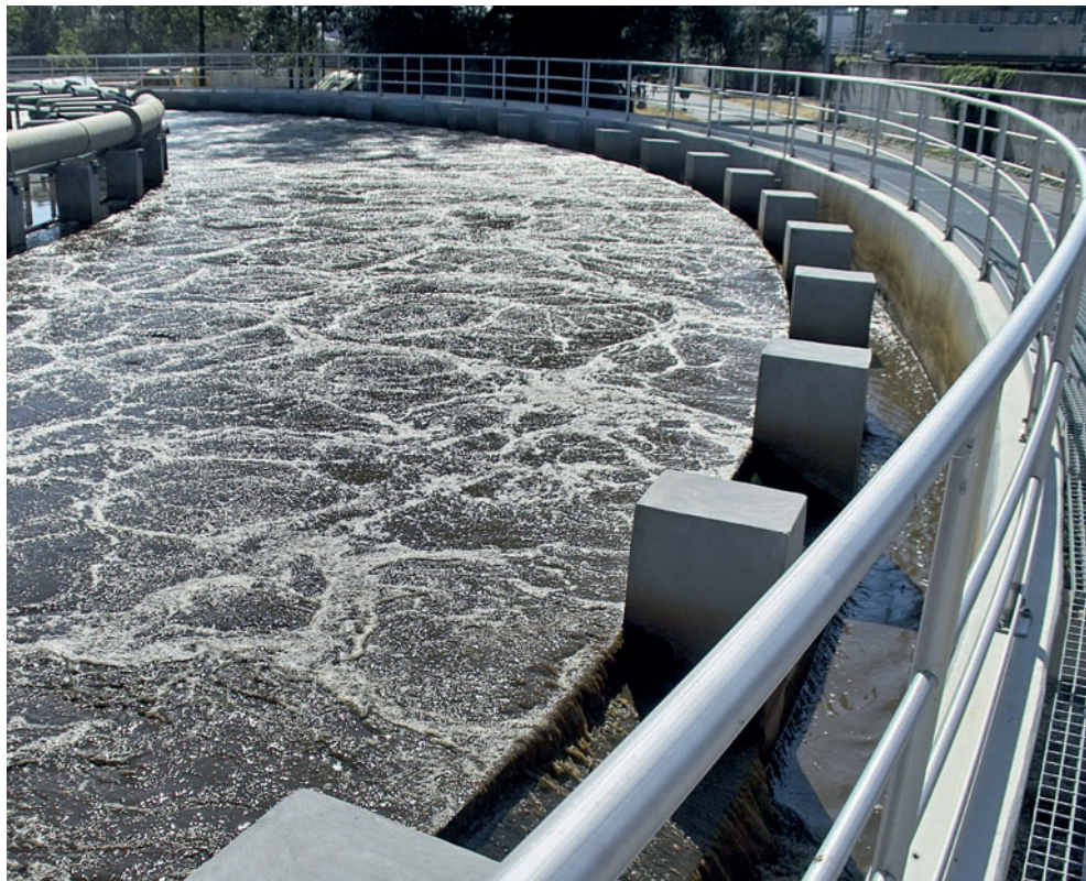
Provdzdušňovací nádrž chráněná systémem MC-RIM PROTECT
